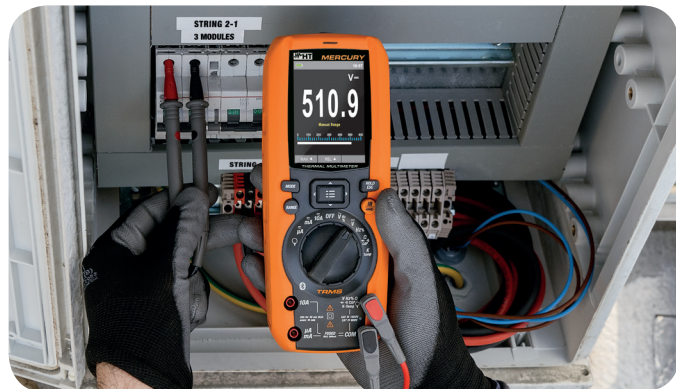
Stringa PV: Mesure de la Voc.
