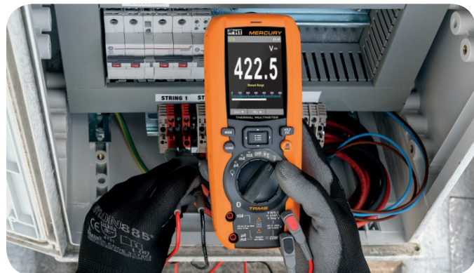
Stringa PV: Mesure de la Vmpp.
