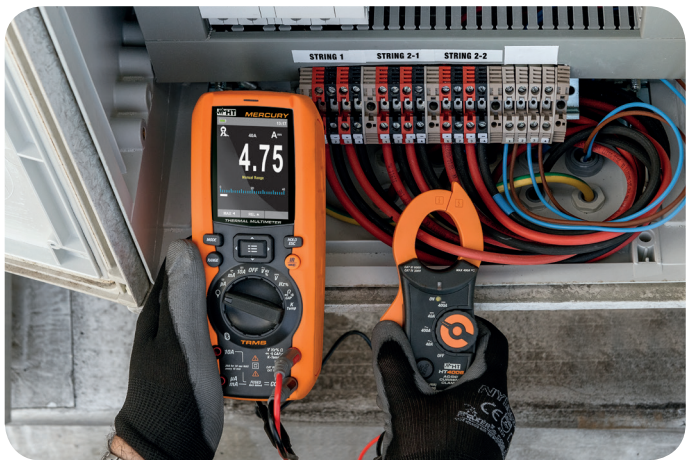
String PV: Mesure de Imp.
