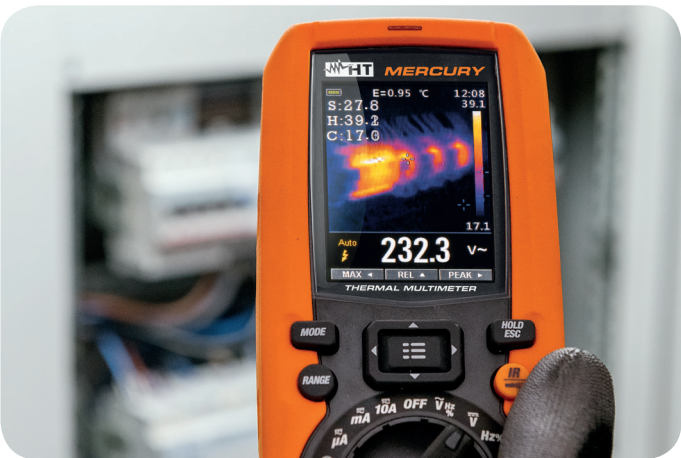
Analyse thermique d'une armoire électrique.
