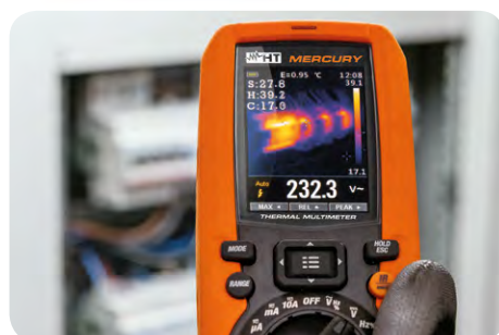
Analyse thermographique du panneau électrique.
