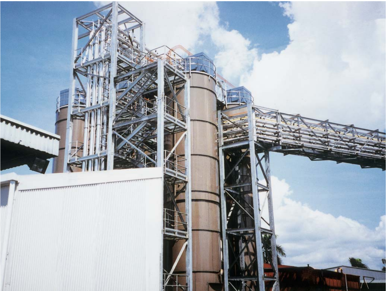
Une installation complète de transport de noir de carbone.
