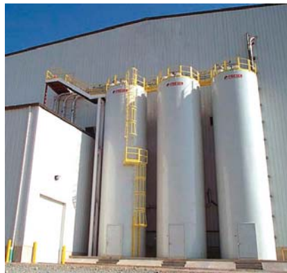
Les silos de stockage sont remplis par un système de transport suivant le Concept de la Ligne Pleine™.
