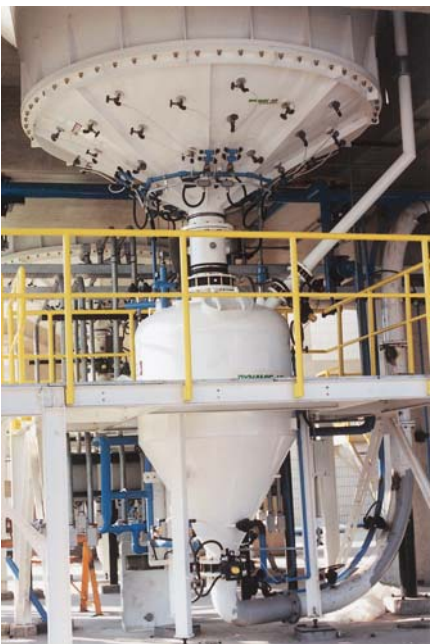
Sas de transport en phase dense avec un système de vidange de trémie à Vibra-Jet™ transportant des détergents
