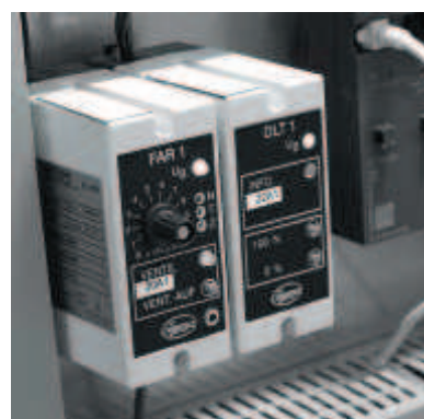
Surveillance électronique de chaudière Electronical boiler monitoring
